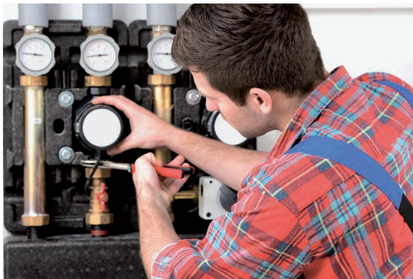
Regelmässiger Service verlängert die Lebensdauer der Heizanlage.
