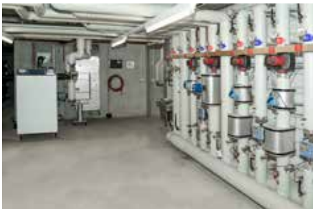
Hinten der WTC GB 170 Gas-Brennwertkessel, rechts die Heizungsverteilung.
