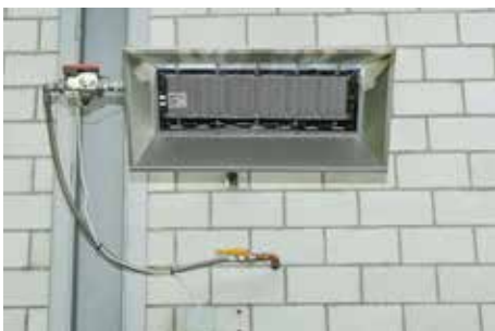
Einer der Gas-Katalytstrahler für die Hallenheizung.
