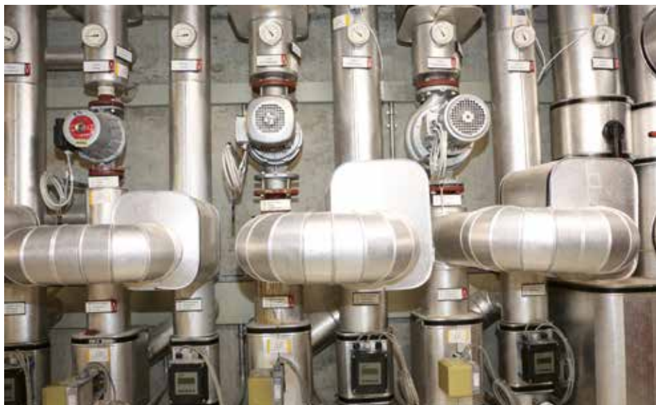
Blick auf den Heizkreisverteiler: Die Schlammheizung für die beiden Faultürme (zwei Abgänge) muss während der ganzen Betriebszeit der ARA gewährleistet sein. (Bilder: Manuel Fischer)
