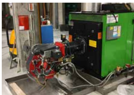
Sicht auf den alten Zweistoff-Industriebrenner kurz vor dem Einbau des neuen Weishaupt-Geräts. (Bild: Weishaupt AG)
