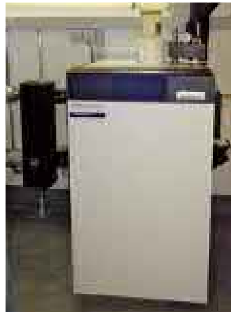
Der Weishaupt-Gas-Standkessel WTC-GB90 in der Heizzentrale des Hotels Opera in Zürich; links die hydraulische Weiche.
