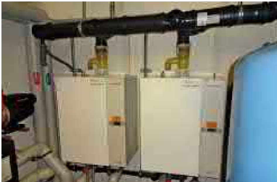
Ein Weishaupt WTC-60A und ein WTC-45 Gas-Brennwert-Wandkessel in der Dachzentrale des Hotels Opera in Zürich.
