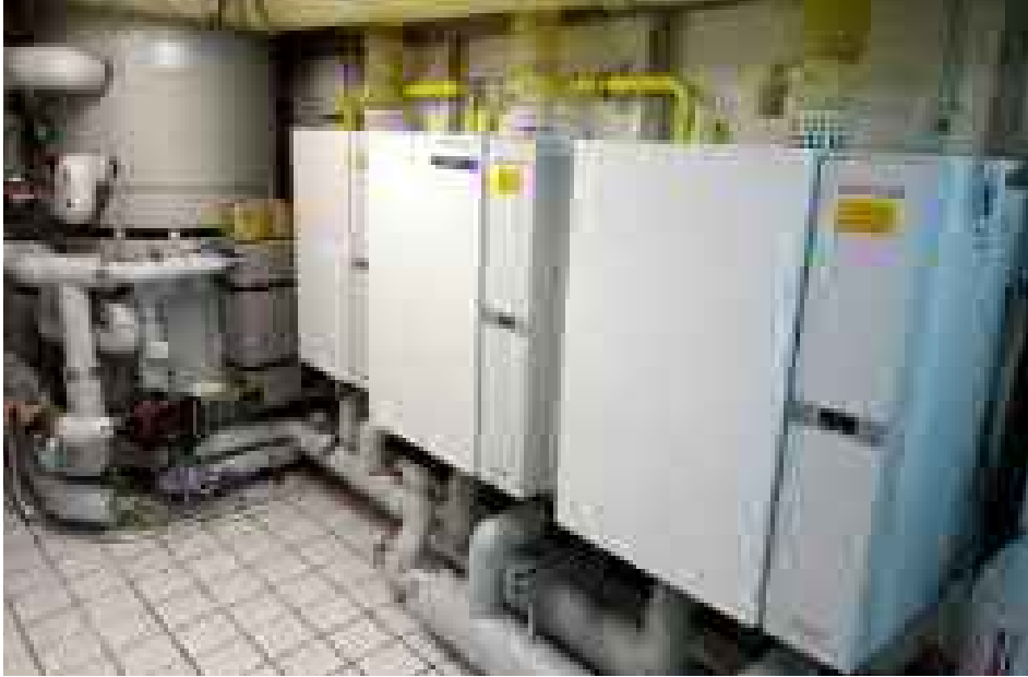
Links im Bild der Weishaupt Gas-Brennwert-Wandkessel WTC-32A, dann folgen die beiden Weishaupt WTC-60A-Wandkessel, links hinten der 500-Liter-Boiler.
