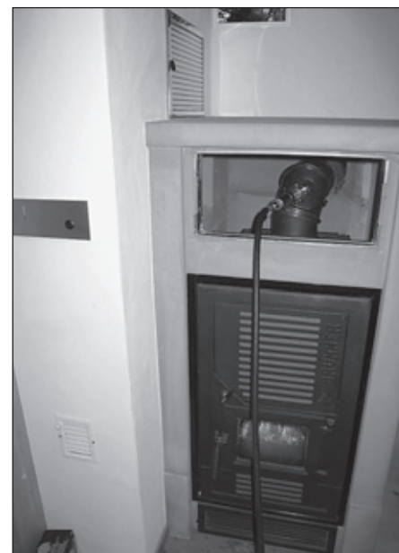
Messort einer kleinen Feuerungsanlage
