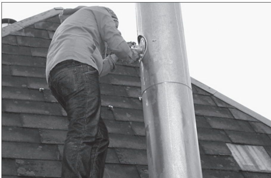
Messort einer grossen Feuerungsanlage
